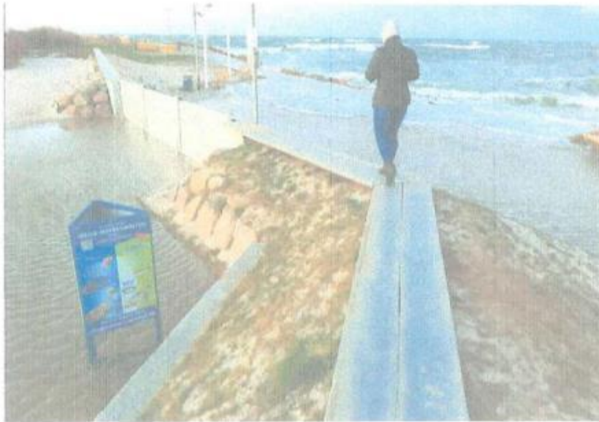
e) Wie zu erkennen funktionierten die baulichen Schutzmaßnahmen gegen das Sturmhochwasser nicht, sie wurden unterspült . Somit wurde das Hinterland unzureichend geschützt.
