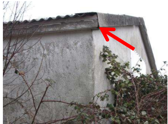
Foto 2: Gebäude 2: wie Gebäude 1, Spalten vorhanden (s. Pfeil)
