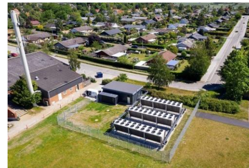
1 MW Luftwärmepumpe (Urheber: PlanEnergi)
